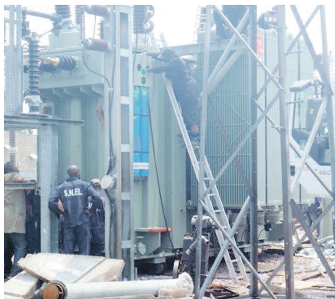
Des transformateurs de la Snel
