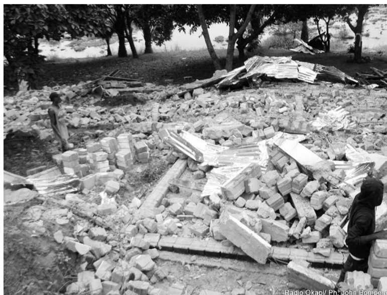
Des ruines d'une maison cassée dans un quartier de Kinshasa
