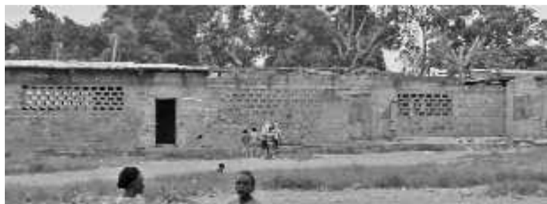
L'érosion qui menace l'école de Mpaka Km8
