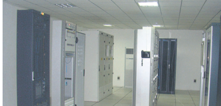
Salle des équipements
