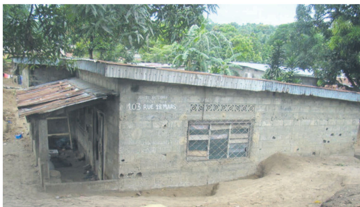
Une habitation menacée par le sable
