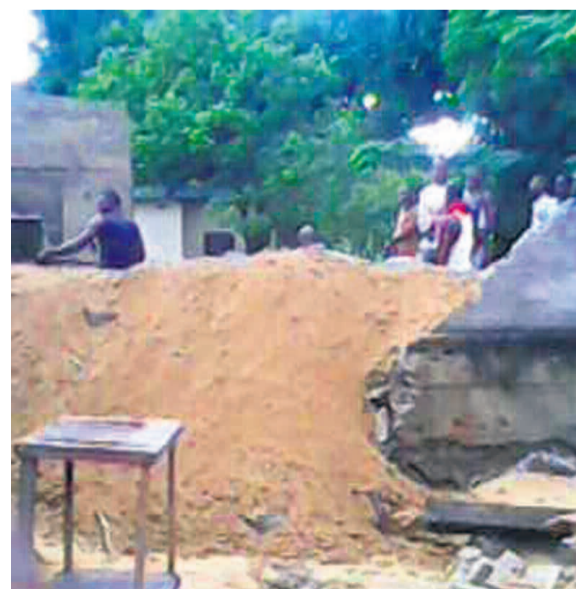
Un mur écroulé
