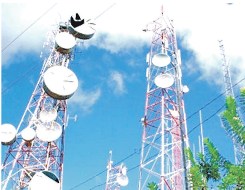
Des antennes relais d'une société de télécommunication cellulaire
