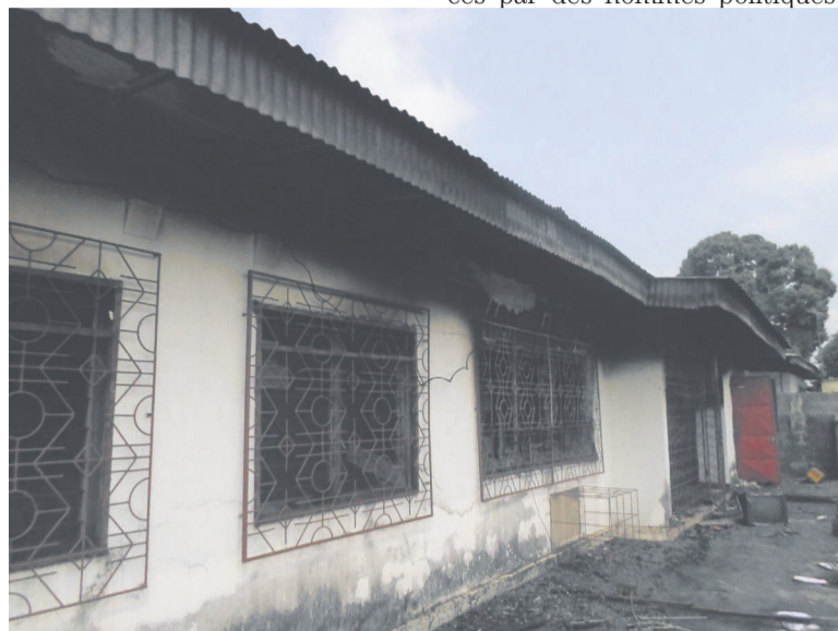
La maison consumée après une fuite au niveau de la cuisinière à gaz
