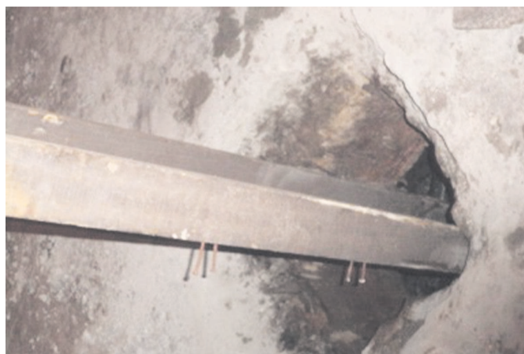
Le puisard dans lequel l'ouvrier a perdu sa vie ; crédit photo Séverin Ngambaye
