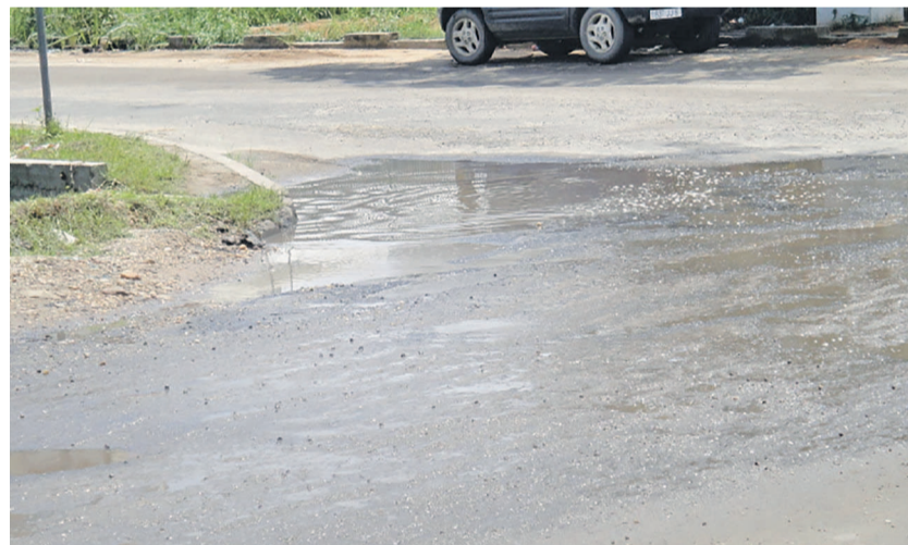
Une mare d'eau stagnante sur la chaussée d'une artère à Pointe-Noire (centre ville)
