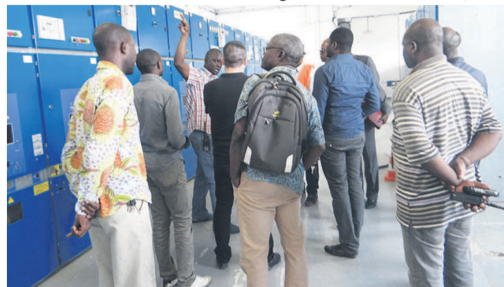
Vue partielle du poste THT Mongo Kamba (DR)
