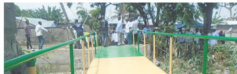
Une vue de la passerelle construite dans le quartier Devala (photo adiac)
