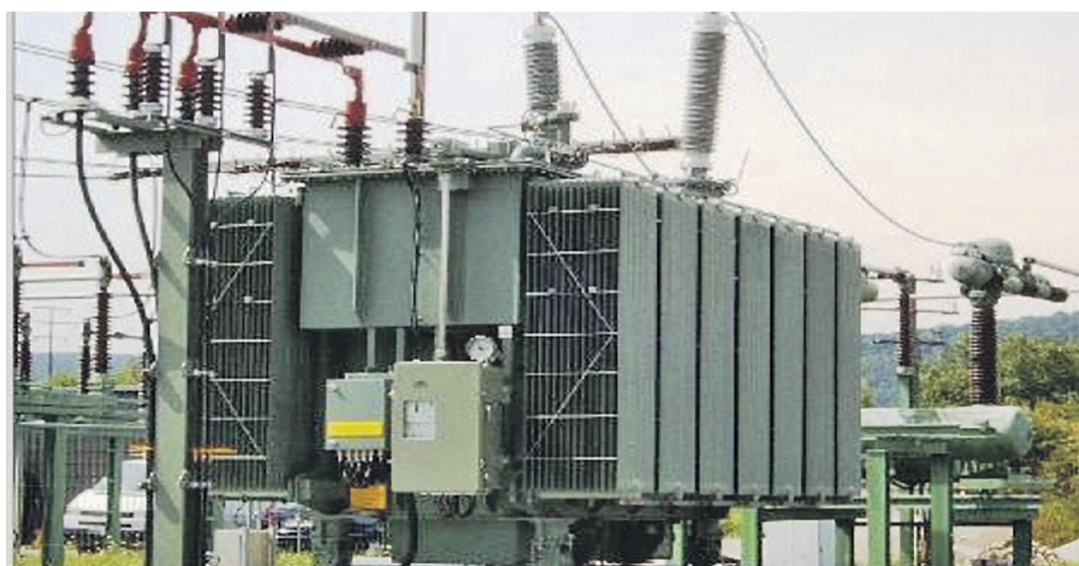
Un transformateur de la Snel
