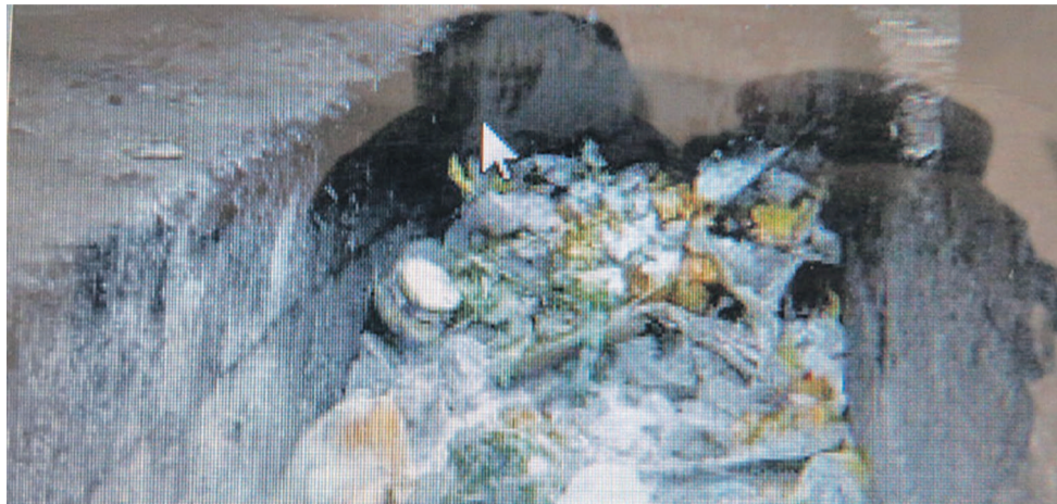
Une partie de caniveau bouché
