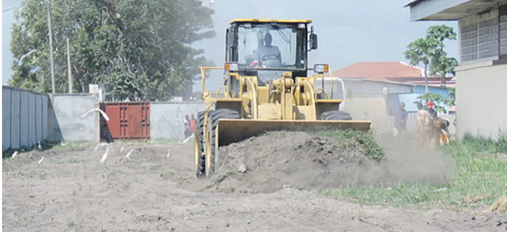
Une vue des travaux de réhabilitation «adiac» -Vue de la niveleuse, après le passage de la pelle mécanique «adiac»
