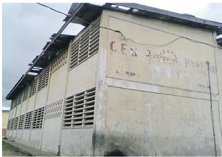
Une vue du premier bâtiment délabré «Adiac»
